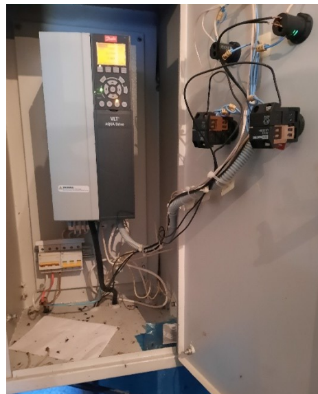
Оборудование (ПЧ) в НС-2п.
